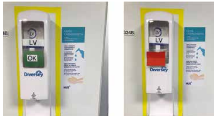
Kuva 3. Desinfektioannostelijoiden merkintävakio. Toimivassa laitteessa tarramerkki on vihreä ja toimimattomassa punainen. Käyttäjä kääntää merkin tarvittaessa. Ohje näkyy käyttöpaikan vieressä. Laitteen näkyvyyttä on korostettu keltaisella huomionauhalla. (Kuvaideasta kiitokset leikkaussalihoitaja Beatrice Kerttulalle)
